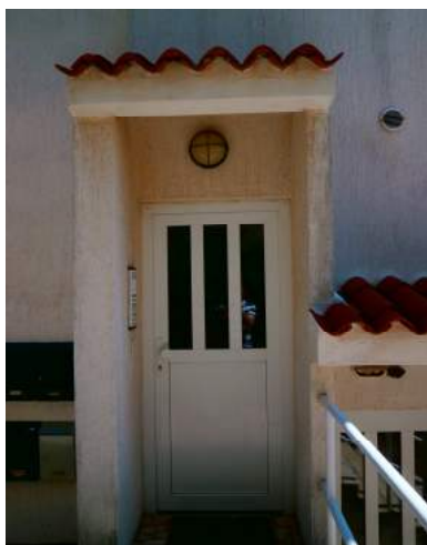
Slika 7. PVC stolarija - ulazna vrata u zgradu
